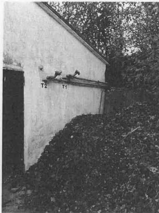
Foto 7 Heizöl-Befüllstutzen und -Zuleitungen im Bereich der Halle (Produktion/Verladung)
