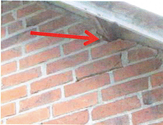
Foto 5: Nebengebäude Alte Landstraße Nr. 36 mit Spaltensituationen (s. Pfeil)
