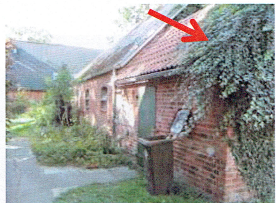
Foto 4: Nebengebäude Alte Landstraße Nr. 36 mit umfangreichem Efeuwuchs (s. Pfeil)
