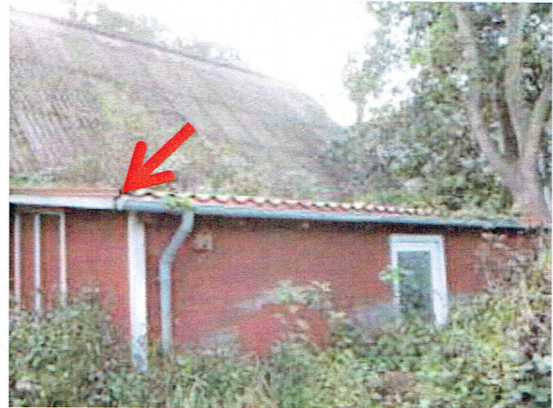
Foto 6: Anbau an Nebengebäude Wohnhaus Alte Landstraße Nr. 36 mit Spaltensituationen (s. Pfeil)
