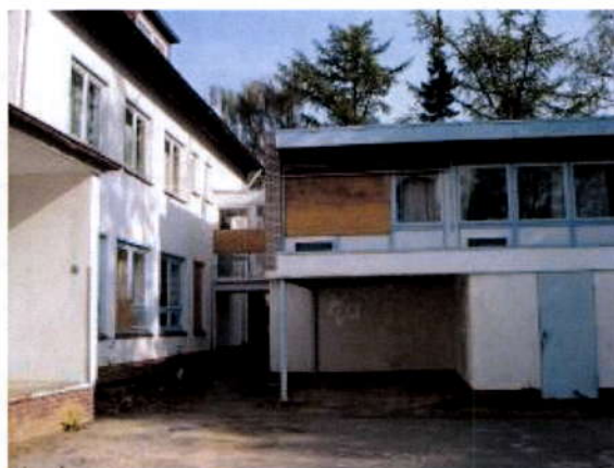
Abb. 3 Einsetzender Vandalismus und vorgenommene Sicherungsmaßnahmen (P. Scharlibbe 29.04.2010)
