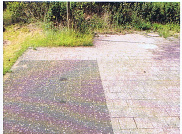
Abb. 16 Detail der Oberflächengestaltung im „Hafenkamp“ mit Hervorhebung der Parkplätze innerhalb der Spielstraße (B. Gaser 10.06.2014)
