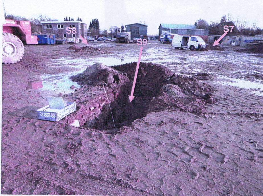
Foto 8: Blick nach Osten über das Grundstück Hauptstraße 64 und die Baggerschürfe S7, S8 und S9 (s. Pfeile), die im Bereich der ehemaligen Lagerfläche von Halde IV ausgeführt wurden.
