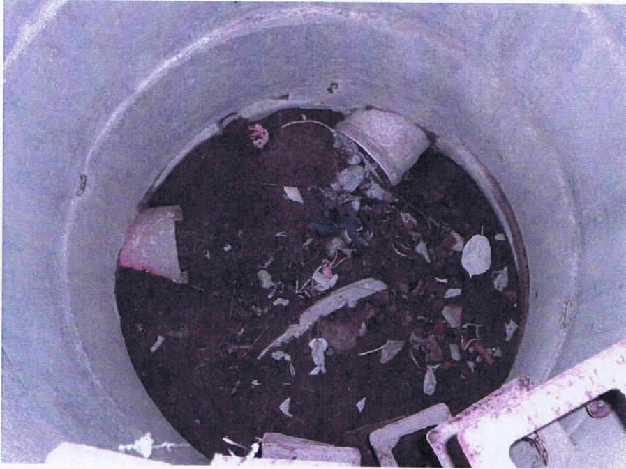
Foto 15: Revisions- / Übergabeschacht Regenentwässerung am Nordende des Regenrückhaltebeckens im westlichsten Grundstücksteil.
